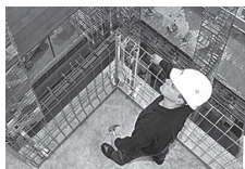
Sistemi di sicurezza
