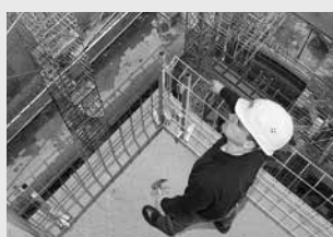
Sistemi di sicurezza
