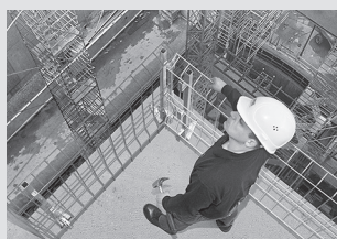
Sistemi di sicurezza
