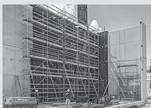
Impalcature per l'edilizia
