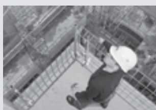
Sistemi di sicurezza
