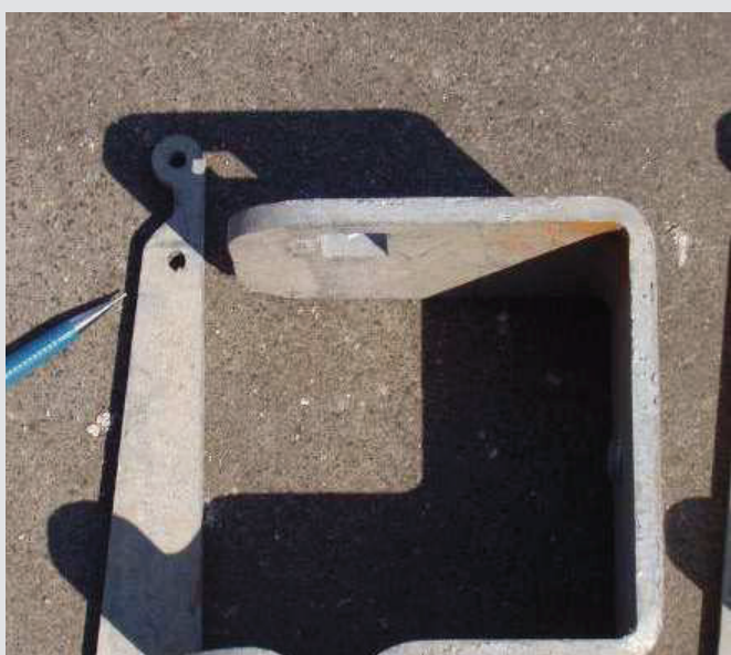
Spina elastica del cuneo di fissaggio dell'attacco UVA mancante
