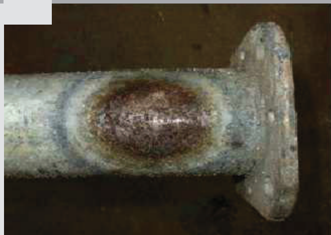
Dimensioni dell'area danneggiata
