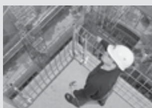
Sistemi di sicurezza
