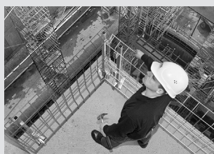
Sistemi di sicurezza
