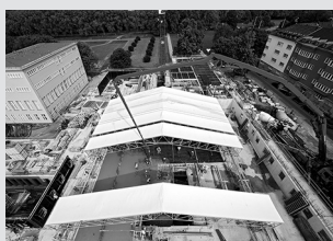
Impalcature di sicurezza
