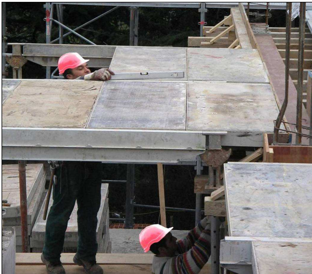
Immagine 6: Messa a livello dal basso del tavolato di pannelli Modul mediante regolazione delle viti dei puntelli.
