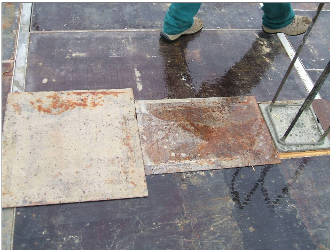
Immagine 8: Compenso con le apposite lamiere fissate con chiodi ai pannelli Modul.
